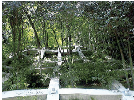
龍間(3)地区急傾斜地崩壊防止工事 大阪府:枚方土木事務所
